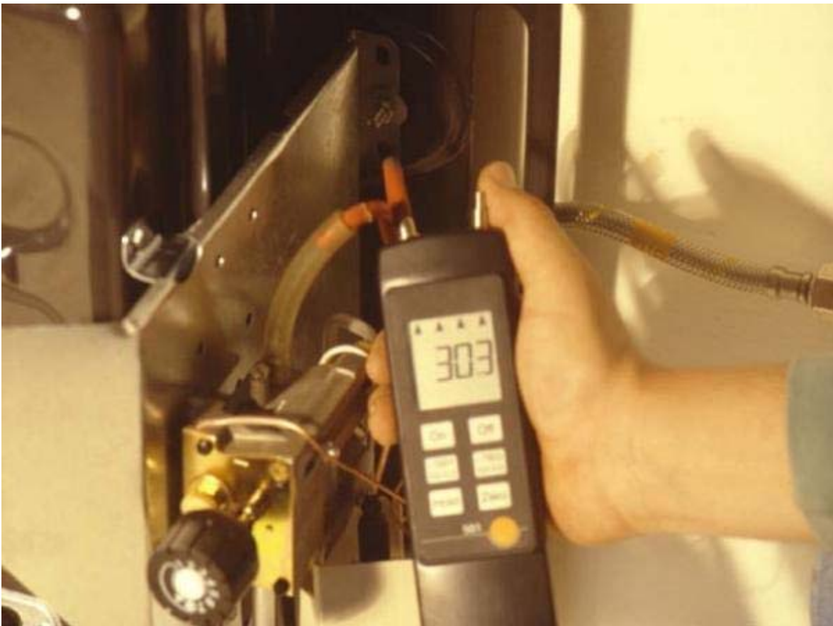
6. Измерение сетевого давления газа (при работе запальной горелки)
